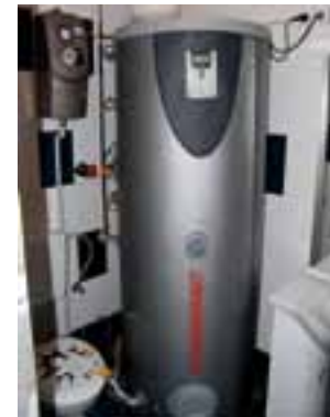
Solarni kolektorski sustav za pripremu potrošne tople vode
