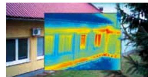
Toplinski nezadovoljavajuće izolirana zgrada
